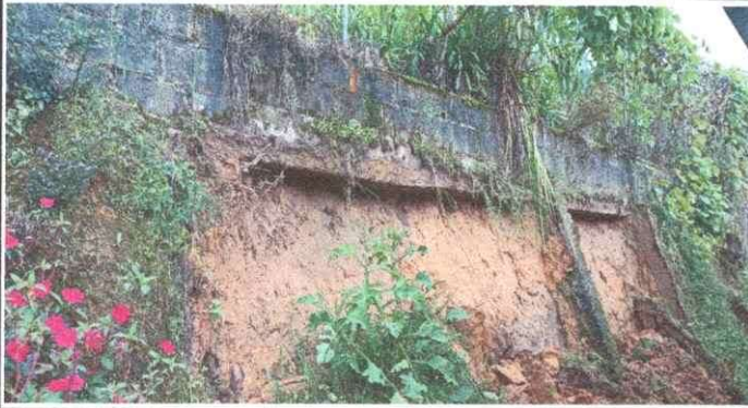
Foto 1: Vista lateral del muro del perímetro escolar, donde se refleja el deterioro en que se encuentra.
