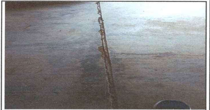
Foto 4: Este piso ya se encuentra en mal estado teniendo muchas grietas.
