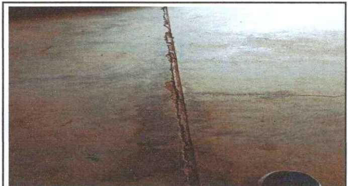
Foto 4: Este piso ya se encuentra en mal estado teniendo muchas grietas.
