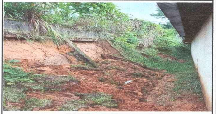
Foto 2: Se observa el muro en pesimas condiciones.
