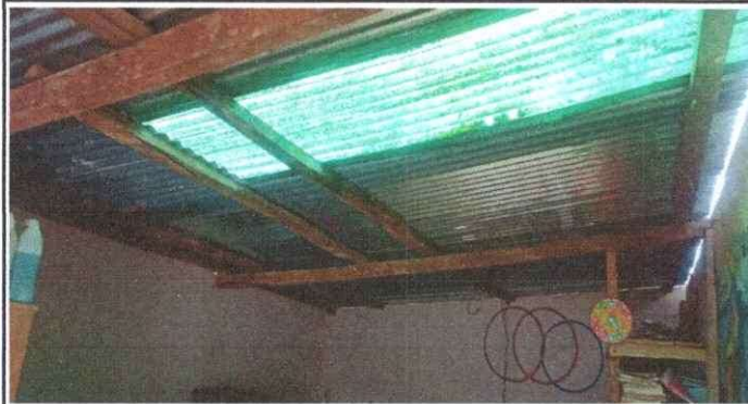
Foto 1: Vista lateral del entechado donde se refleja el deterioro en que se encuentra.
