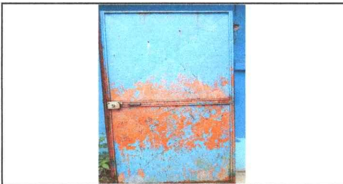
Foto 5: Se observa el deterioro de la puerta.
