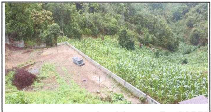
Foto 6: muro perimetral, se necesita darle seguimiento ya que esta deteriorado.
