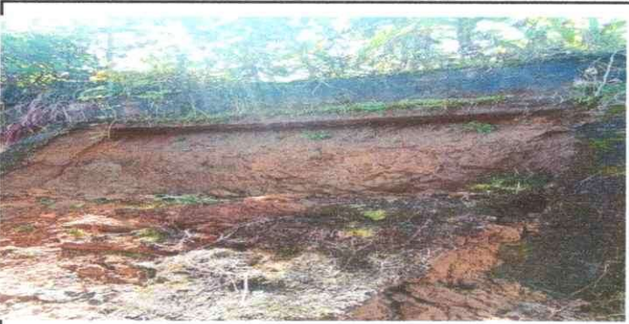
Foto 3: Se observa el gran riesgo que se tiene en el perímetro del establecimiento, lo cual es de prioridad ya que somos areas de mucha lluvia y deslaves como se observa en la presente fotografia.
